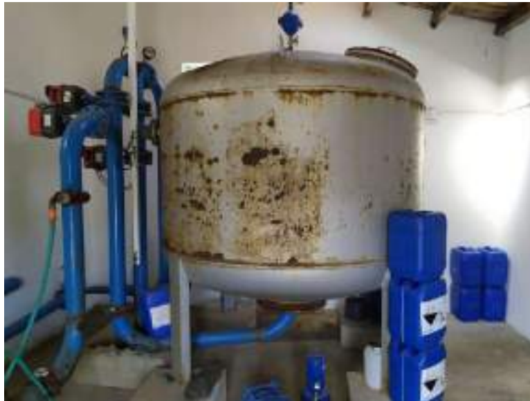
Imaxe: Tratamento filtración e sala de mand
